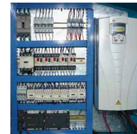
电气控制系统 Electrical control system
