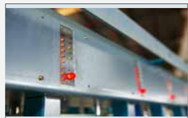
电气控制系统 Electric control system
