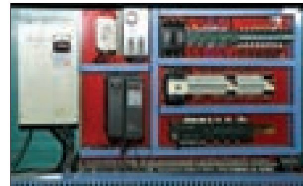
电气主控系统 Electrical control system
