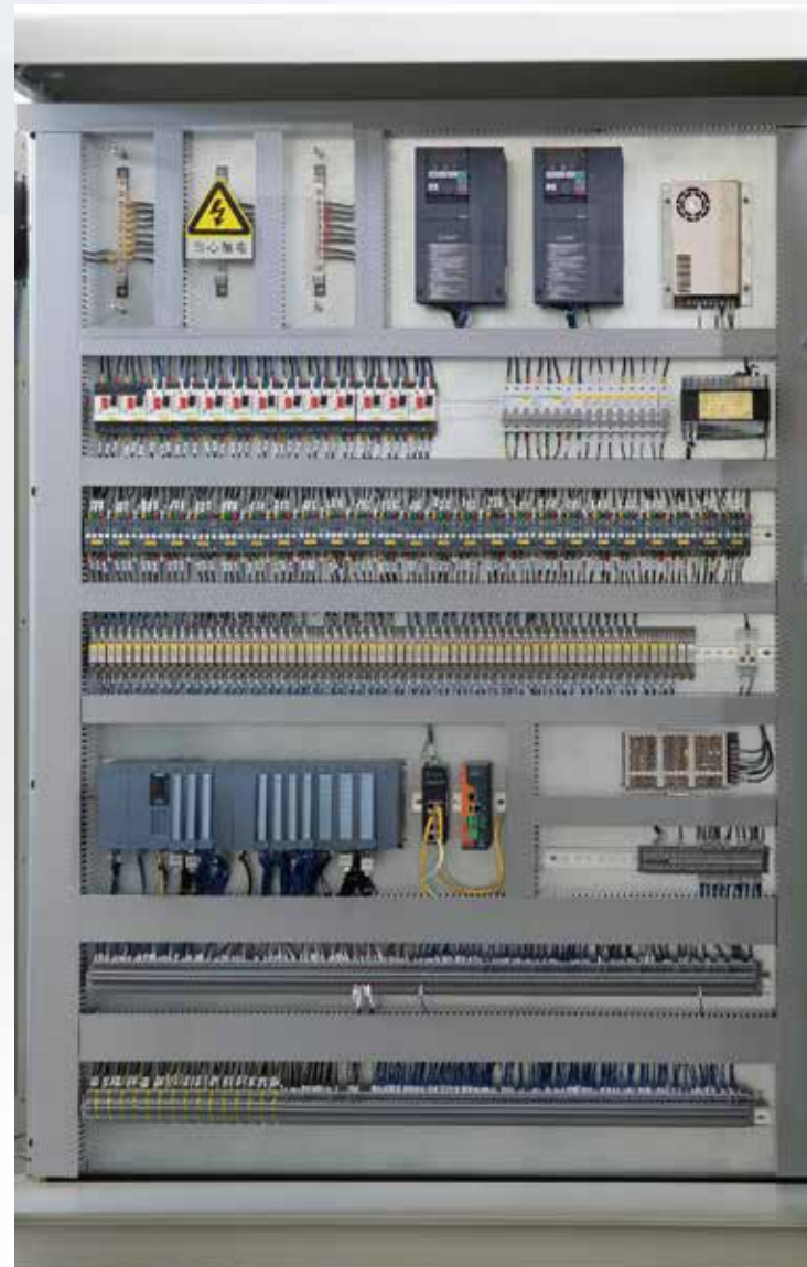
Внутреннее содержимое электрического шкафа Interior of electric cabinet
